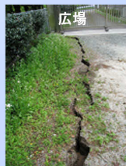
地割れ(車両周回路)です。駐車場のアスファルトにも亀裂が入ってます。
